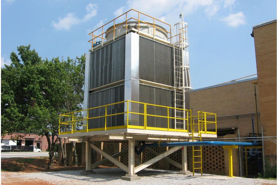
60 HP Fan Dry Cooling Tower
